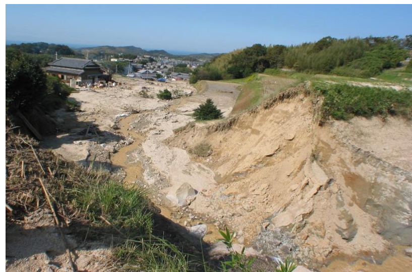
越流によって破堤した瀬戸池（兵庫県）
