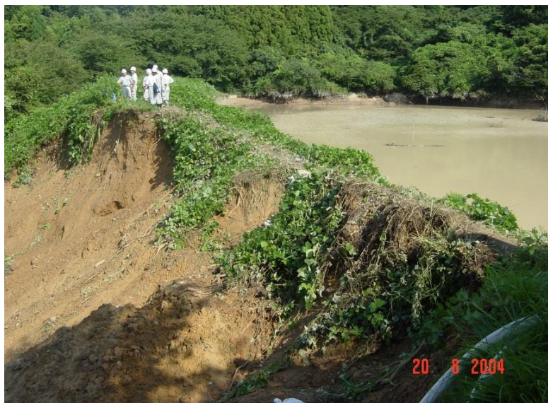
豪雨によってすべり破壊した臼切池（愛媛県）
