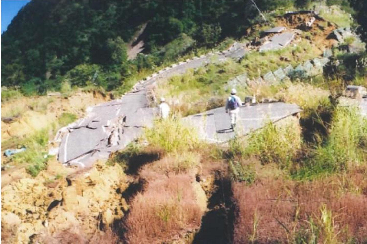
導院線一崩壊
