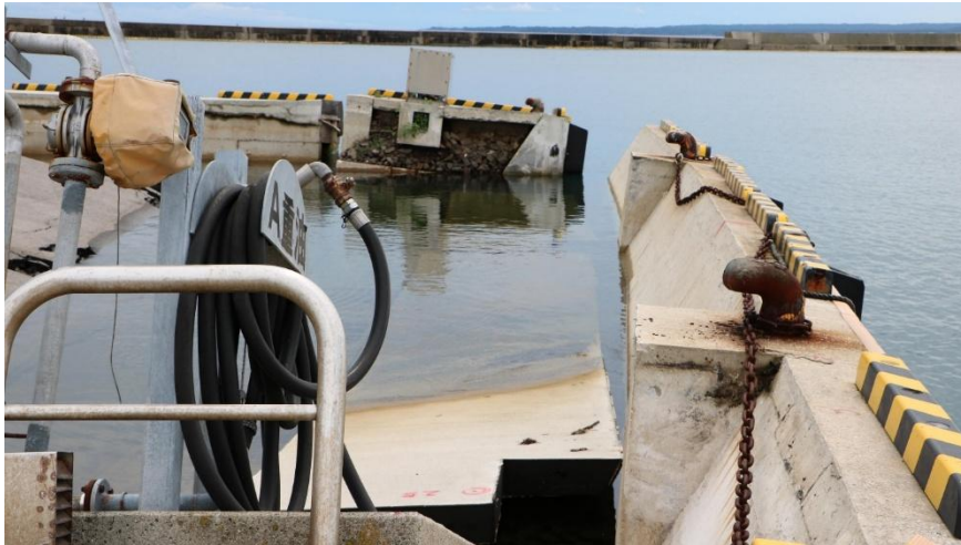
写真4 給油施設の破損（蛸島漁港、珠洲市）
