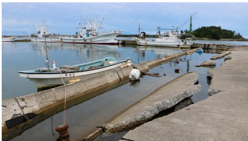
写真 3 護岸の崩壊（蛸島漁港、珠洲市）
