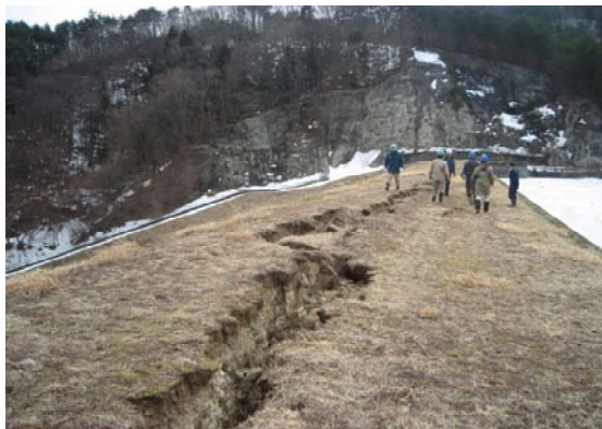
■三ツ森池の亀裂(福島県) 天端部の亀裂の発生と法面の崩壊
