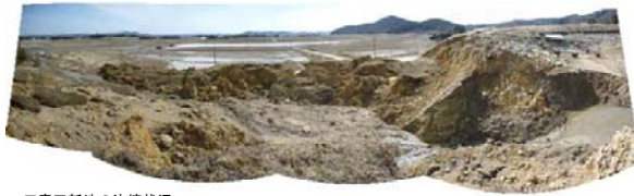
■青田新池の決壊状況 ため池堤体が決壊し下流の農地に大きな被害が発生
