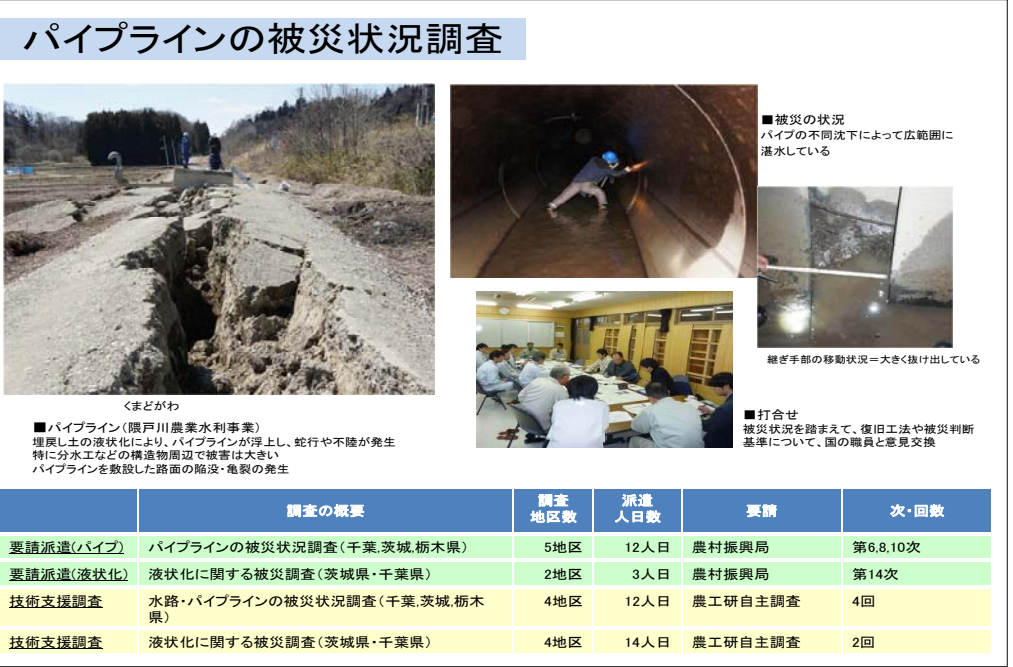
図 4 液状化被害対策、パイプラインの被害調査や復旧
