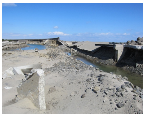
(a) 海岸堤防の損壊
